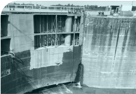
brama doku pływającego
